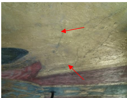
Рис. 5. Тріщини в тинькуванні в осях В-Г×5-6
