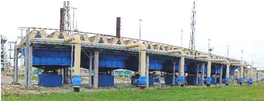
Рис. 6. Зовнішній вигляд установки очищення технологічного газу на об'єкті КІС
