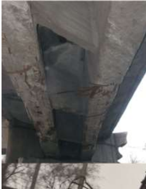
Рис. 7. Прольотна будова з пошкодженими балками
